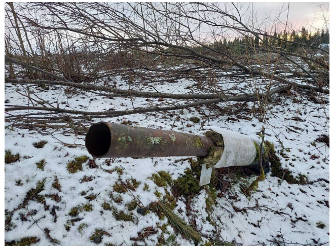
KK4 vieressä putkea
