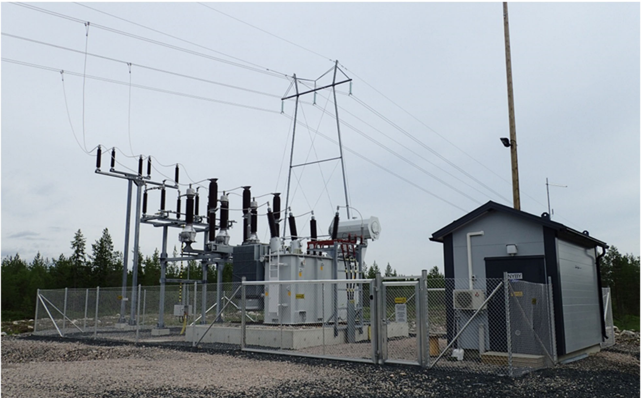
Kuva 70. Esimerkki tuulivoimapuiston sähköasemasta (kuva: FCG).
