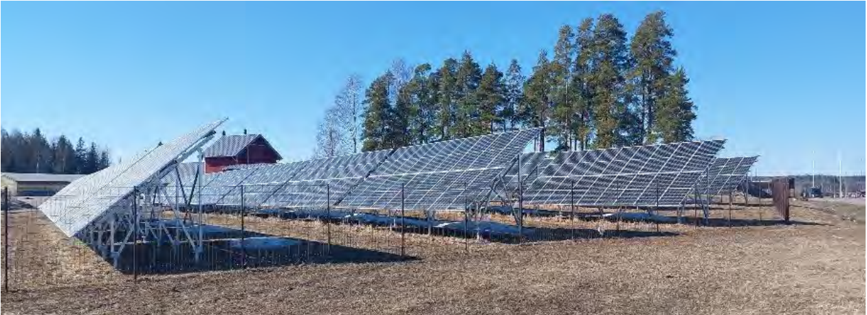
Kuva 13. Aurinkopaneelikenttä (Lähde: Solmar Consulting)
