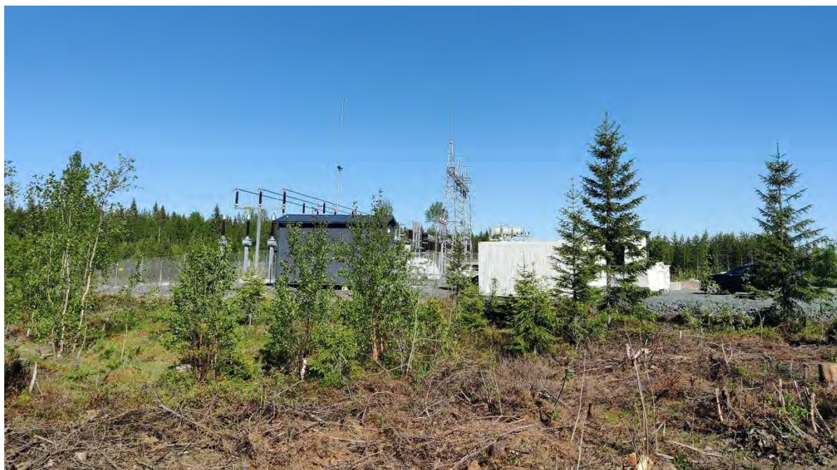
Kuva 25. Rieskannevan sähköasema reitin SVE2 päätepisteessä.
