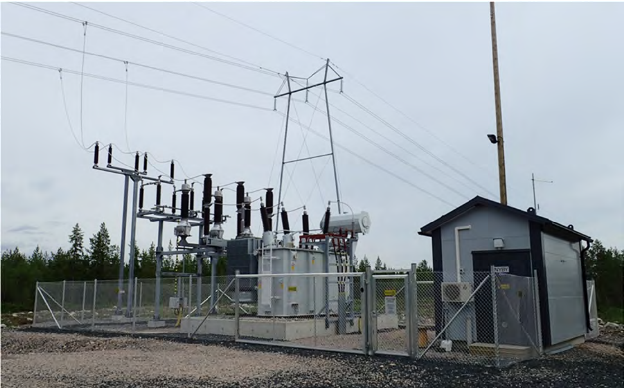
Kuva 68. Esimerkki tuulivoimapuiston sähköasemasta (kuva Minna Takalo/FCG).
